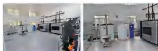
临淄区引调水管网一体化提升改造工程项目 (次氯酸钠发生器3kg/h×2, 1用1备)
