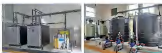
聊城市城南供水5万吨/天 (次氯酸钠发生器:7kg/h×2, 1用1备)
