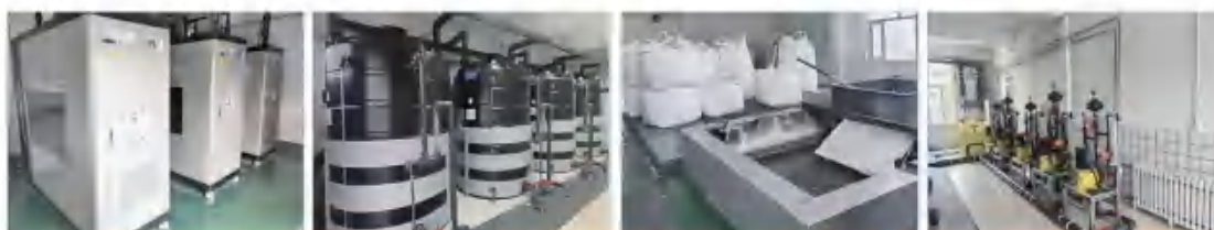
临沂水务集团第一水厂30万吨/天 (次氯酸钠发生器:20kg/h×3 (2用1备))
